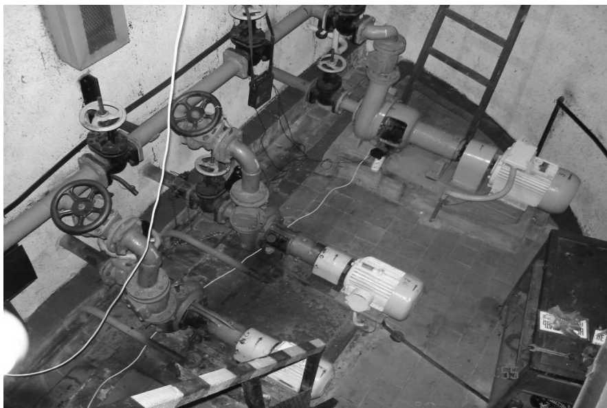
Рис. 1. Общий вид машинного зала исследуемой канализационной насосной станции
