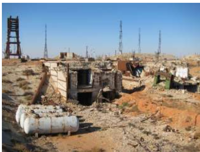
Рис. 1. Повреждения на стартовом сооружении после аварийного взрыва
